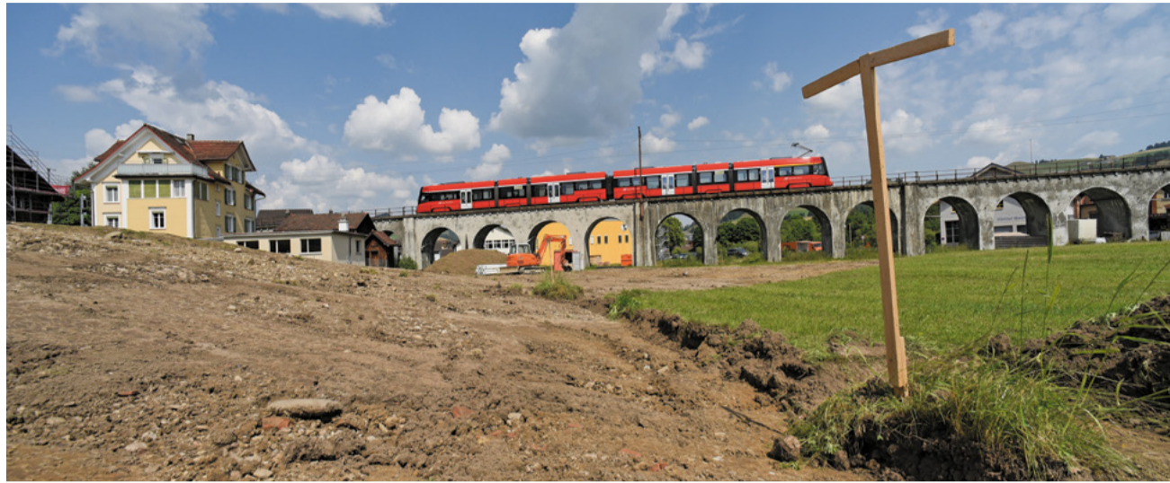
Am Donnerstag startete in Appenzell mit der Baustelleninstallation sowie der Entfernung von Humus die Realisierung der neuen Erschliessungsstrasse im Bereich der Liegenschaft Gärbers. Anschliessend kann die «Alpenbitter»-Erweiterung gebaut werden. (Bild: Hans Ulrich Gantenbein)
